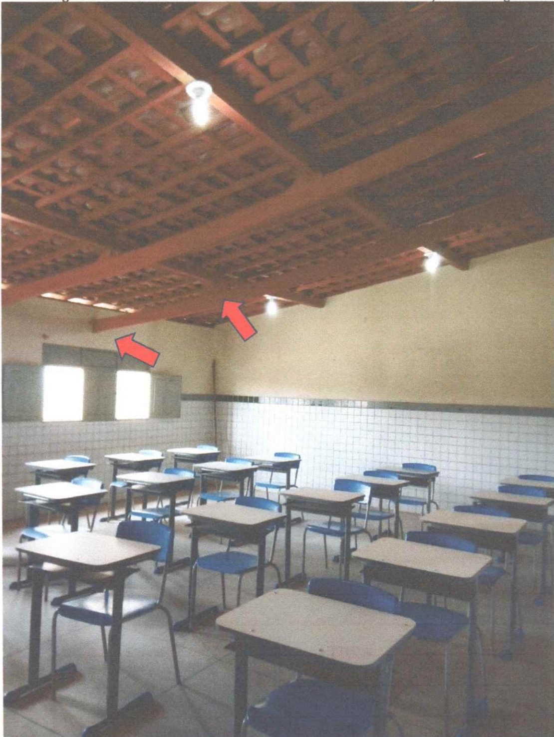
Imagem 17: Setas indicando uso incorreto com cunha na linha e instalação sobre verga
